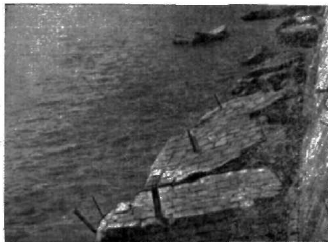
Рис. 124. Разрушение набережной морским прибоем
